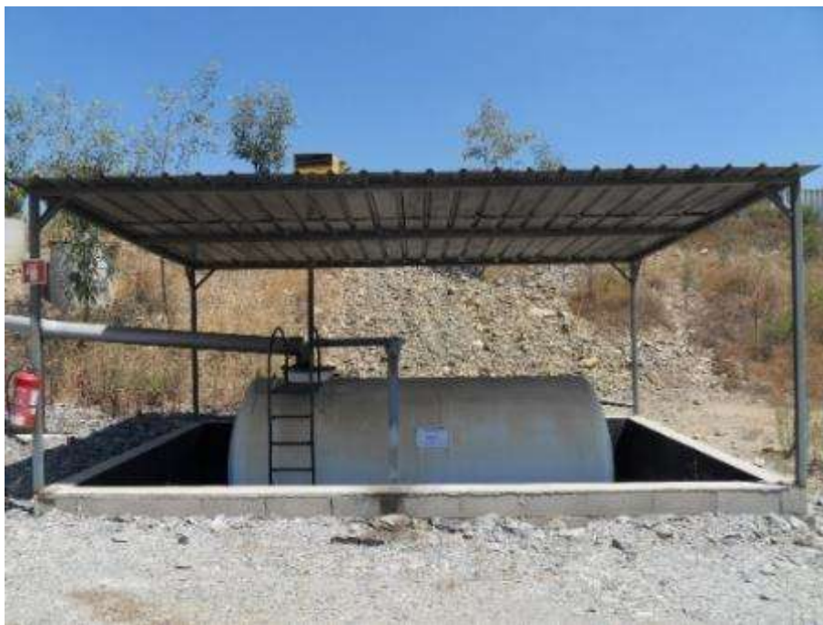
Figura 17 – Reservatório de óleos usados
