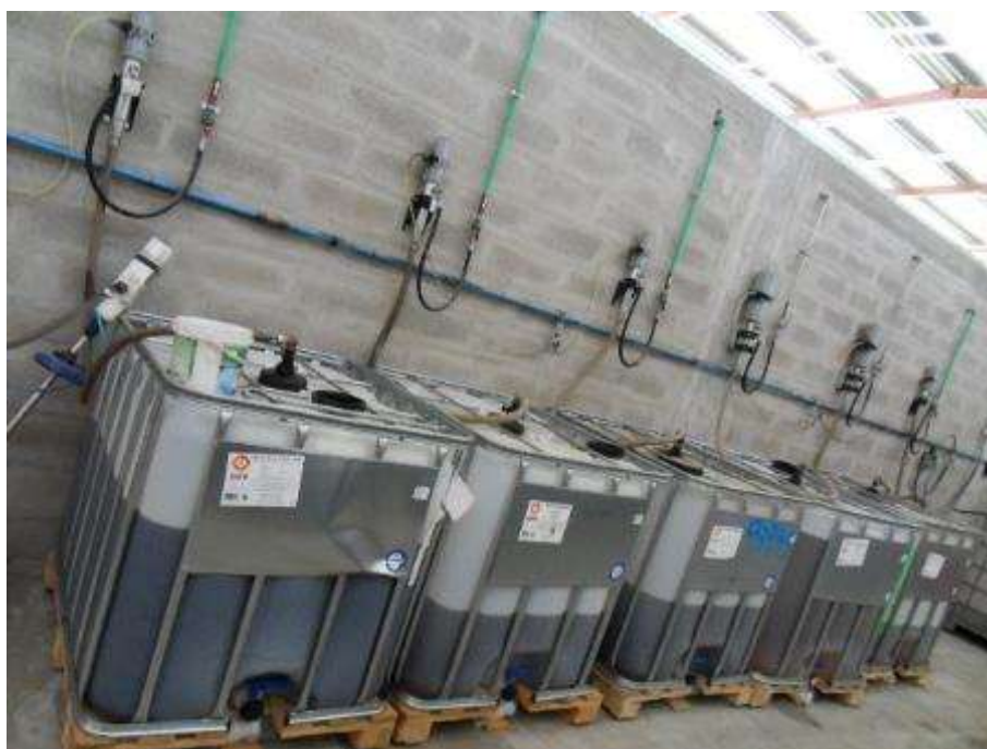
Figura 4 – Bacia de armazenagem: Lubrificantes
