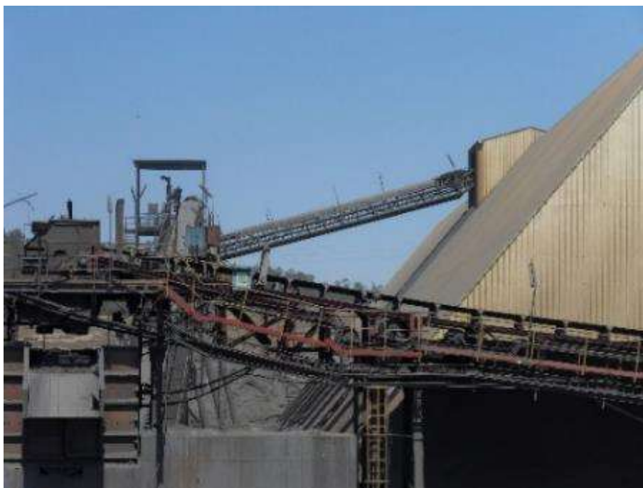
Figura 21 – Telas transportadoras: chegada ao stockpile
