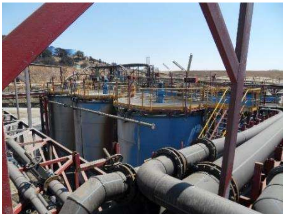
Figura 12 – ETAML e tubagens de efluentes
