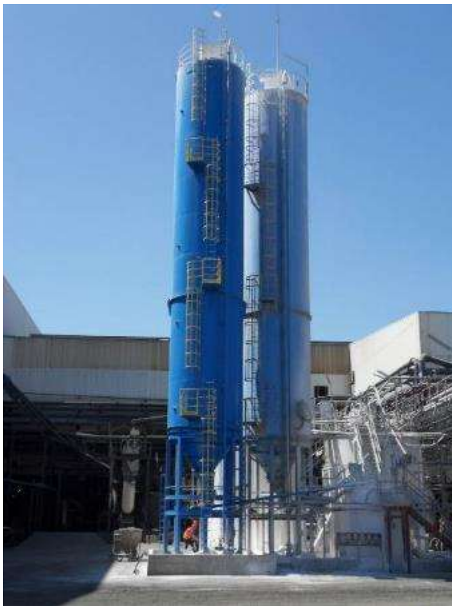
Figura 7 – Silo de armazenamento da cal
